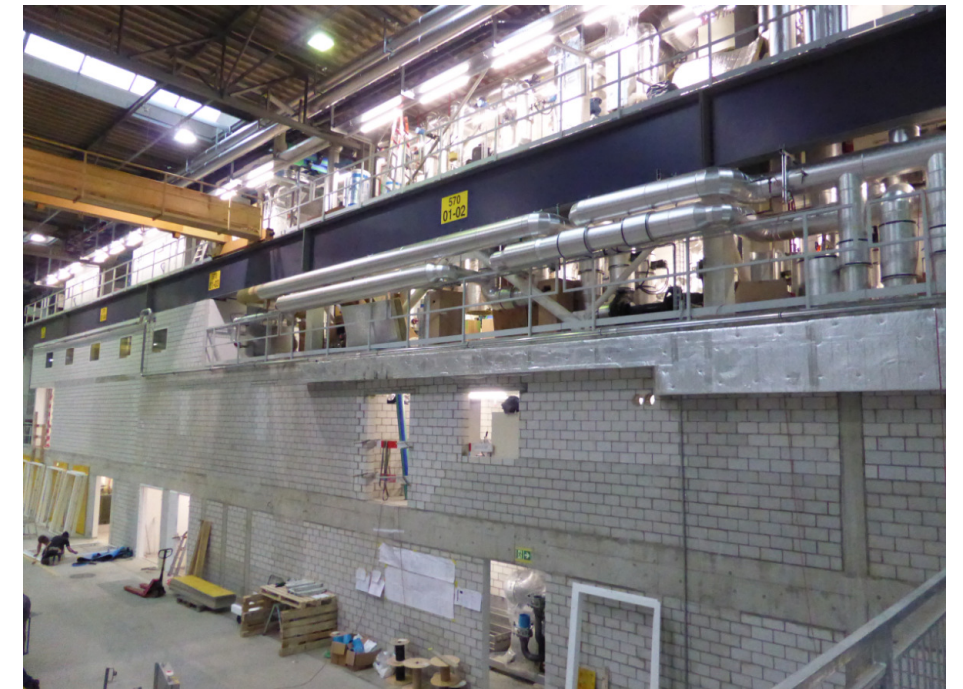
Ausschnitt der neuen 4-geschossigen Energiezentrale
